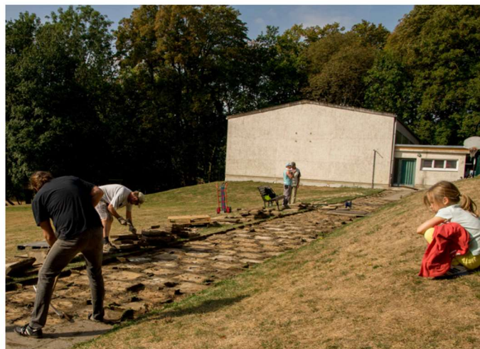
Start der Bauarbeiten. Da wo die Baustraße hinkommt werden Gehwegplatten in Eigenleistung aufgenommen.
